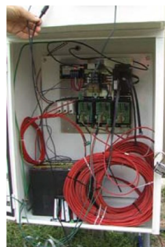
Fig.2 遠隔監視システム
