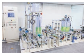
広島市中区の広島テクニカルセンターには、教育・研修用に縮小したモデルプラントを設置。計測・制御の基本を学べます。
